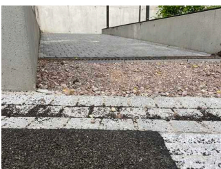
Rampe zum Eingang – schwieriger Übergang zur Rampe
