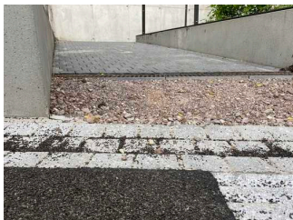
Rampe zum Eingang – schwieriger Übergang zur Rampe
