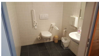
WC im Haus 2
