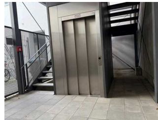
Aufzug zu allen Etagen
